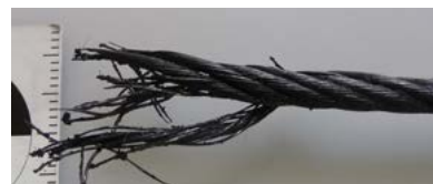
▲ Een deel van de gebroken kabel.
