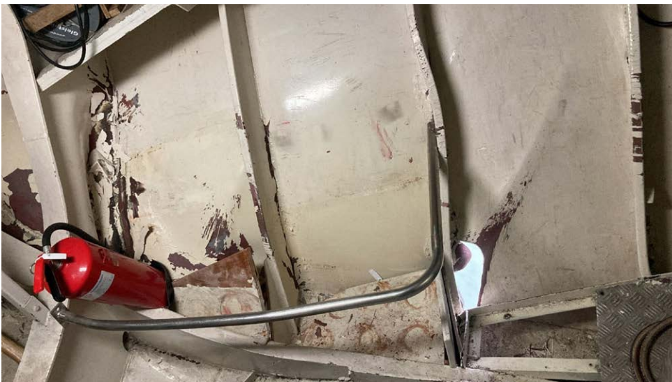
◀ Figuur 22: De schade aan de binnenzijde van het schip. (Bron: STC Eendracht)
