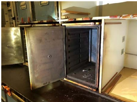
▲ De oververhitte oven.
