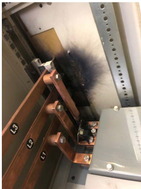
▲ Figuur 23 Brand in schakelbord. (Bron: MV Jade)
