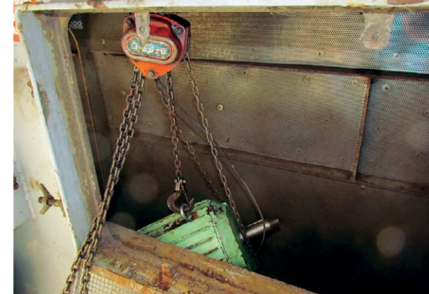
Ventilatieschacht en elektromotor. (Bron: Maersk)
