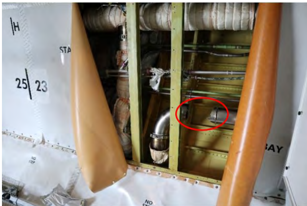
▲ Gebarsten pneumatische leiding.
