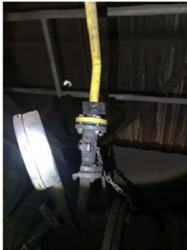
Afblaasleiding met afsluiter GK351
