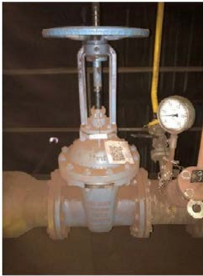
GK 301 (Afsluiter in de kookgasleiding)
