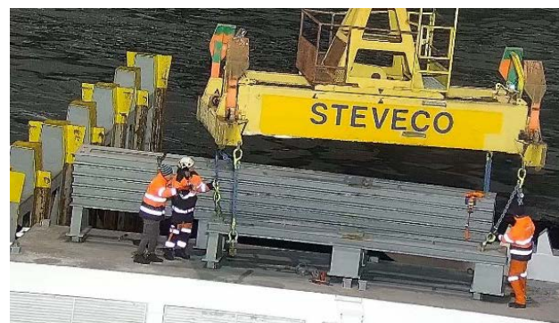
▲ De steunbalk wordt met twee haken aan de spreader gehaakt. Ook te zien zijn de twee loshangende haken. (Bron: CCTV Steveco)
