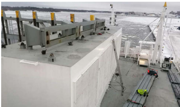
▲ Omgevallen steunbalk op het ventilatiehuis en steunbalken neergekomen op het lager gelegen dek naast het ventilatiehuis. Daarnaast de los geplaatste ladder waarmee de personen het ventilatiehuis opgingen. (Bron: Spliethoff)
