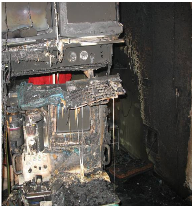
Figuur 16: Op de wand achter de verbrande anesthesieapparatuur is een brandspoor zichtbaar met de linker flank van een 'V'-patroon
