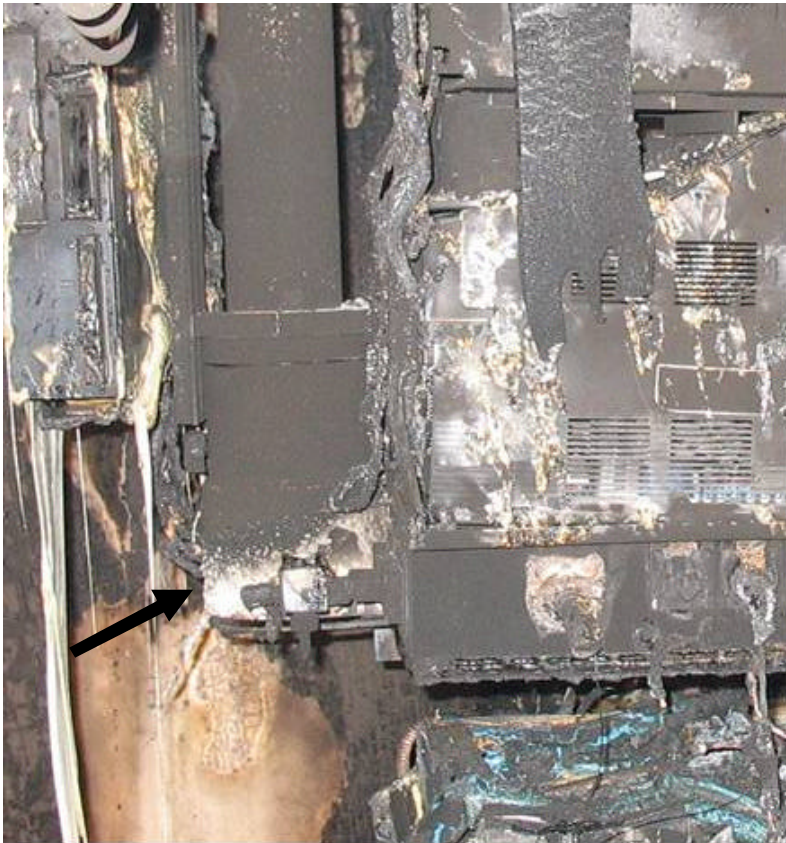
Figuur 19: Sporen van sterke warmteontwikkeling aan de onderzijde van de verticale buis
