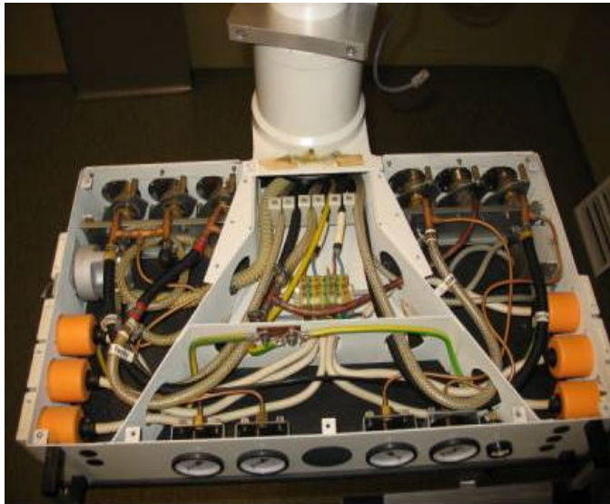
Figuur 4: De foto geeft het bovenaanzicht van een anesthesiependel (vergelijkbaar met die in OK8) die hangt aan de aanvoerbuus. Op de foto is de plaat aan de bovenzijde van de pendel verwijderd.
