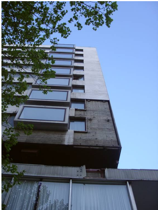
Figuur 1 Schade aan het Hilton Hotel
