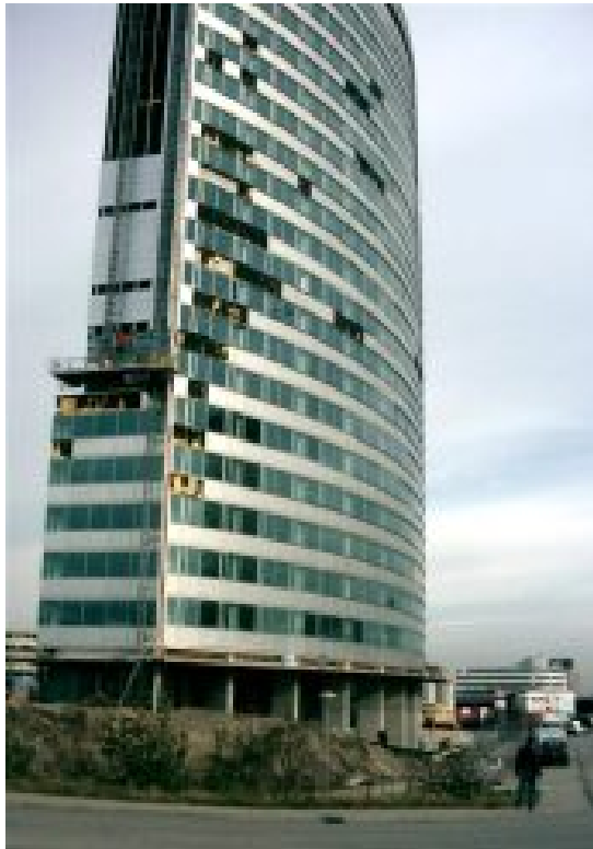
Figuur 3 Schade aan de Pharostoren
