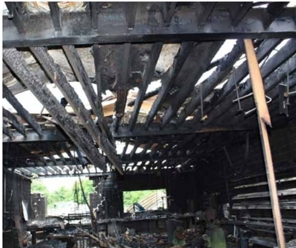
Foto 5 aluminiumwerkplaats - thermische aanval vanuit zolder naar werkplaats toe
