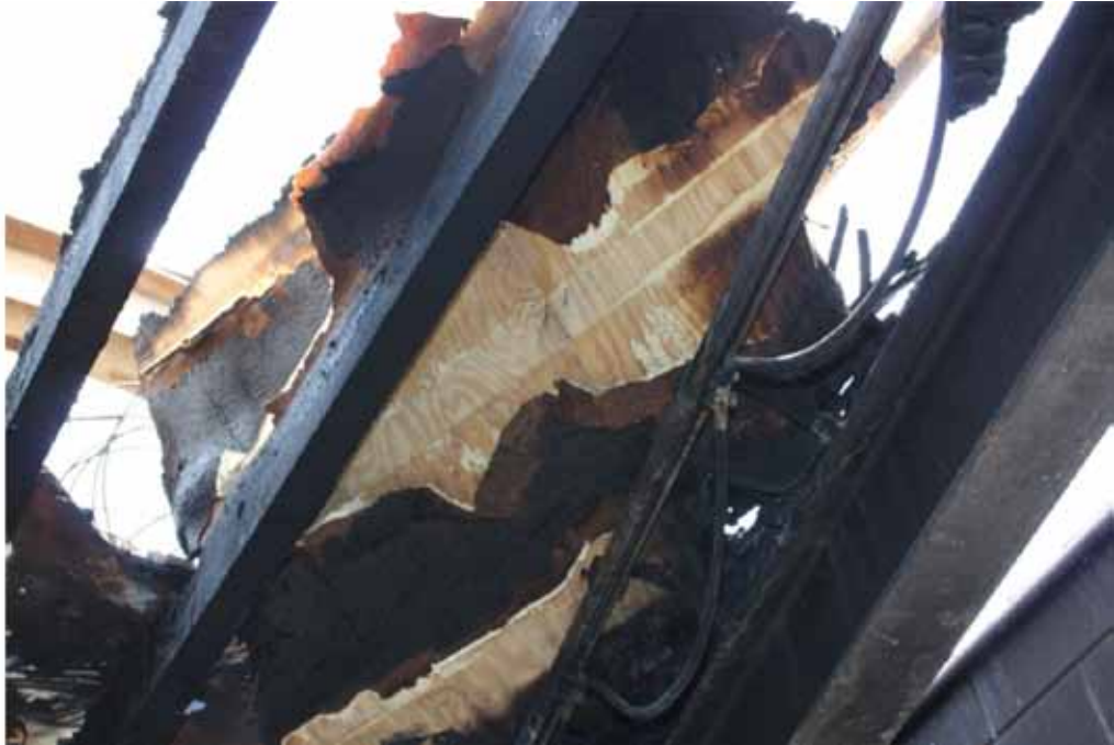
Foto 6 Werkplaats motoren - thermische aanval vanuit zolder naar werkplaats toe
