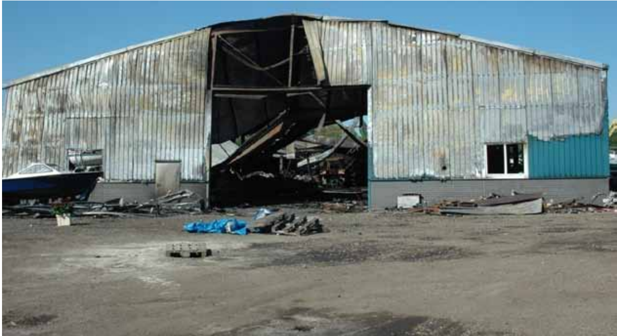
Foto 2 Voorgevel loods na de brand. Het gat boven de deuropening is ontstaan op het moment van de plotse branduitbreiding, toen een deel van de gevel naar buiten werd geblazen.
