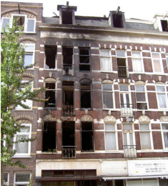
Figuur 4: Beschadigde woonhuis Amsterdam
