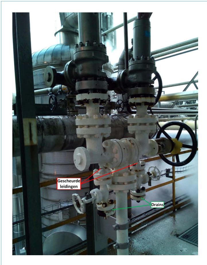
Figuur 3: Set veiligheidskleppen - ieder voorzien van een drain. (Bron: ISZW)
