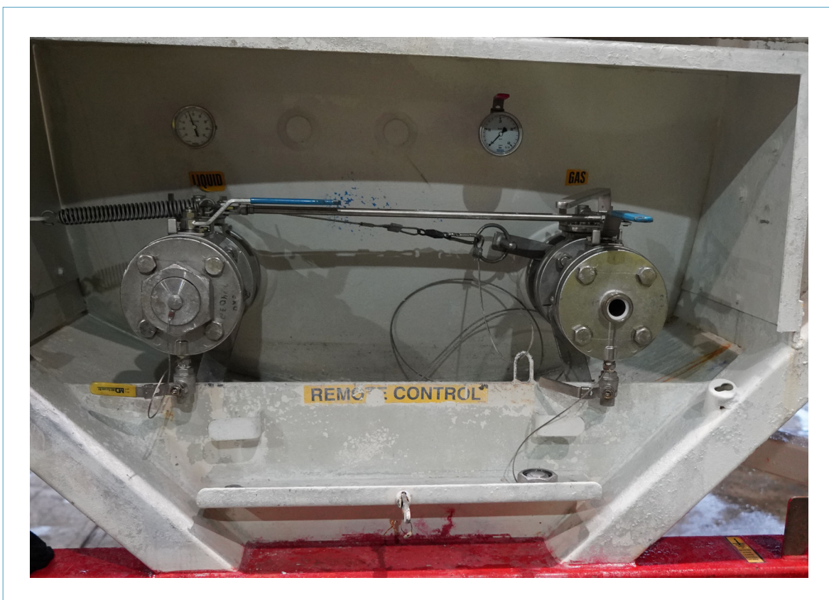
Figuur 3: De vloeistof- en gasfaseopening met ieder drie afsluiters. Links: vloeistoffase, rechts: gasfase. Ook zichtbaar zijn de thermo- en manometer. (Bron: ILT)
