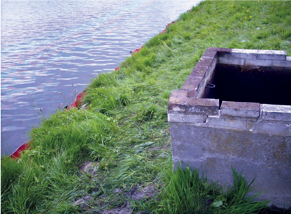
Figuur 6: Oliefilm op het oppervlaktewater, ter plaatse van de inspectieput, gefotografeerd in de ochtend na het voorval. (Bron: omgevingsdienst Noordzeekanaalgebied)
