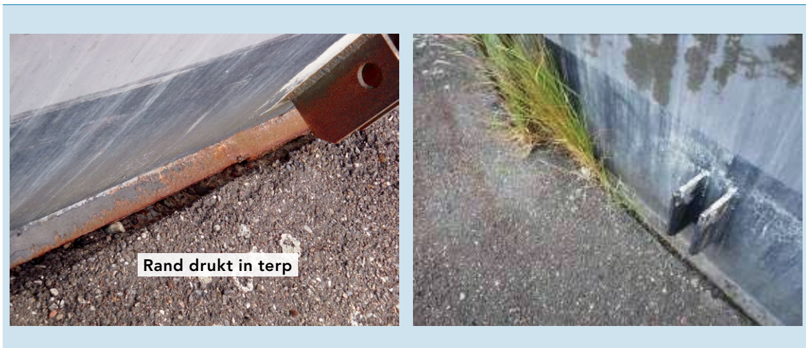
Figuur 10: Zichtbare verzakking in de terp. (Foto links bron: Openbaar Ministerie, foto rechts bron: EuroTank)
