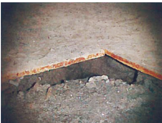
Figuur 11: Holte onder de tankbodem, zichtbaar na het uitnemen van het plaatmateriaal. (Bron: Inspectie SZW)
