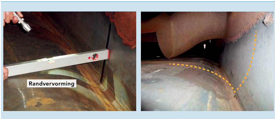
Figuur 8: Randzetting, te zien aan de binnenzijde van tank A. De gele lijn geeft de naar beneden gebogen randzetting aan. (Foto links bron: Openbaar Ministerie, foto rechts bron: EuroTank)
