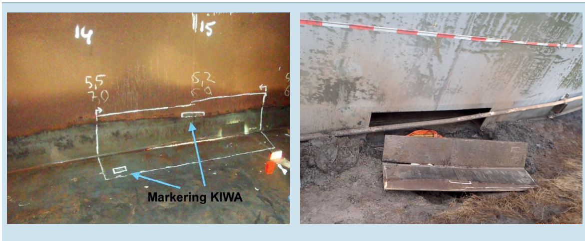
Figuur 13: Uitname plaatmateriaal ten behoeve van technisch onderzoek. (Bron: Rapport 'Onderzoek aan gefaalde opslagtank C115', 21 april 2014, Element Materials Technology in opdracht van Kiwa Nederland B.V. en Inspectie SZW.)
