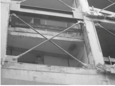
Een gevelement valt als gevolg van ondeugdelijke bevestiging. Het effect bevindt zich in de BVZ.
