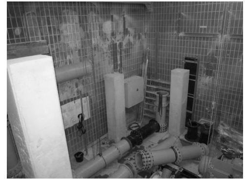
Een onderdeel van een installatie valt als gevolg van een onjuiste hijsmethode. Het effect bevindt zich in de BVZ.
