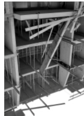
Een aantal houten elementen vallen als gevolg van een ondeugdelijke bevestiging. Het effect bevindt zich in de BVZ.
