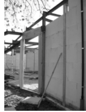
Een kalkzandsteenblok valt als gevolg van een ondeugdelijk hijsmiddel. Het effect bevindt zich in de BVZ.
