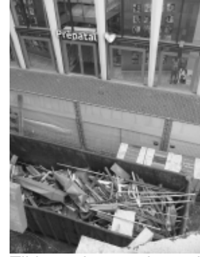
Tijdens sloopwerk wordt een onderdeel uit een gebouw geworpen en kaatst op een container. Het effect strekt zich uit tot driemaal de BVZ.
