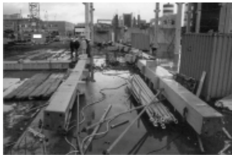
Een kolom valt tijdens de montage als gevolg van een onvolledig werkplan. Het effect bevindt zich in de BVZ.
