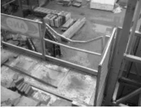
Een kozijn kaatst op een steiger als gevolg van een onjuiste werkmethode. Het effect strekt zich uit tot tweemaal de BVZ.
