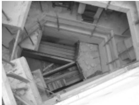
Een pakket kalkzandsteenblokken valt als gevolg van instabiele opslag. Het effect bevindt zich in de BVZ.
