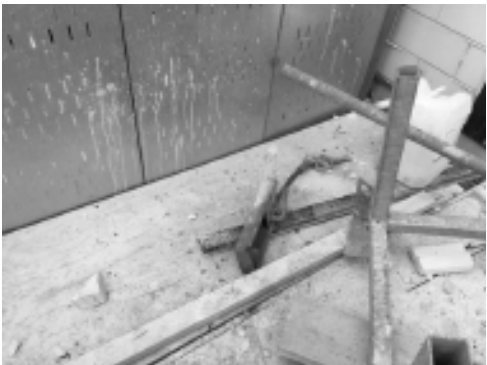
Een hijsbok met bekistingsonderdelen valt als gevolg van onjuist onderhoud. Het effect bevindt zich in de BVZ.
