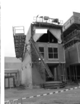
Een steiger valt als gevolg van een ondeugdelijke bevestiging. Het effect bevindt zich in de BVZ.
