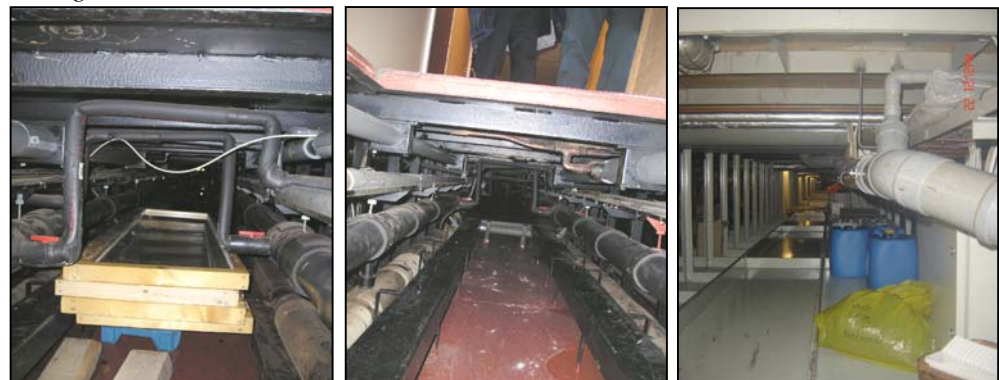
Figuur 5 Leidingen- en pijpentunnel onder (stalen) vloer
