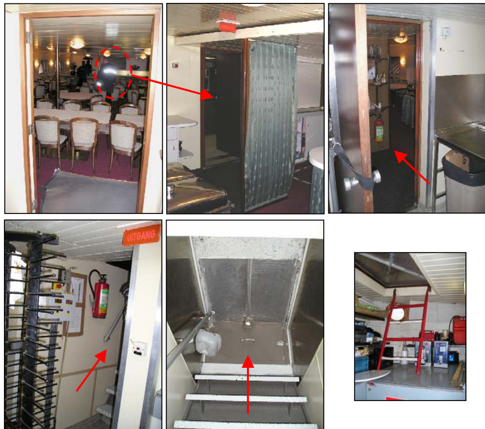
Figuur 16 -Vluchtroute vanuit restaurant achter scherm langs, door keuken, trapje op, luik door -Twijfelachtige begaanbaarheid van een vluchtroute via een opslagruimte naar een laddertje (foto rechtsonder)
