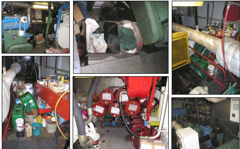
Figuur 1 Rommel/ opslag in de machinekamer
