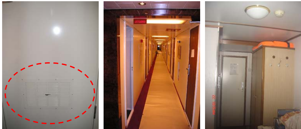
Figuur 7 Ventilatie-rooster in deur hut en niet-zelfsluitendheid van hutdeuren
