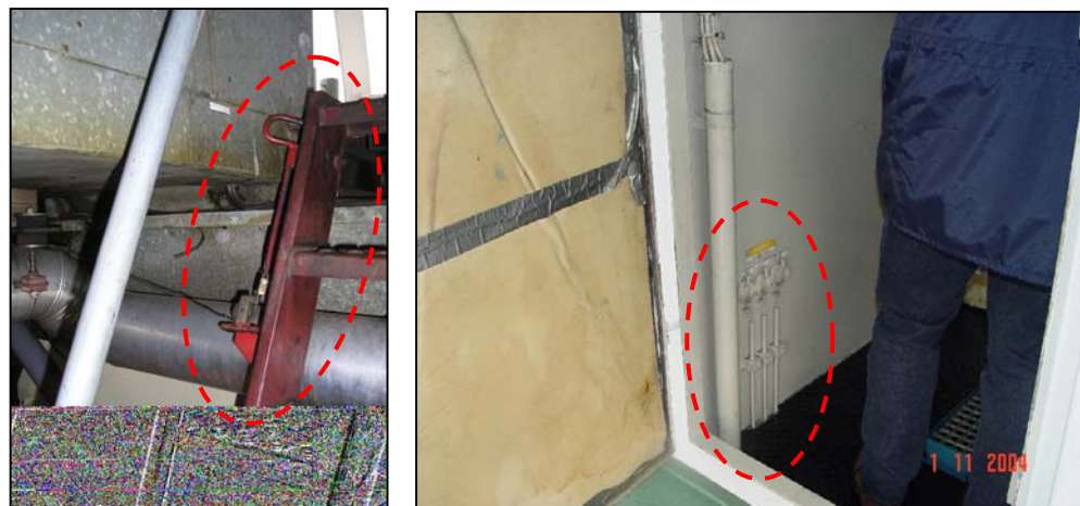
Figuur 3 Noodstop van installaties gesitueerd in de machinekamer
