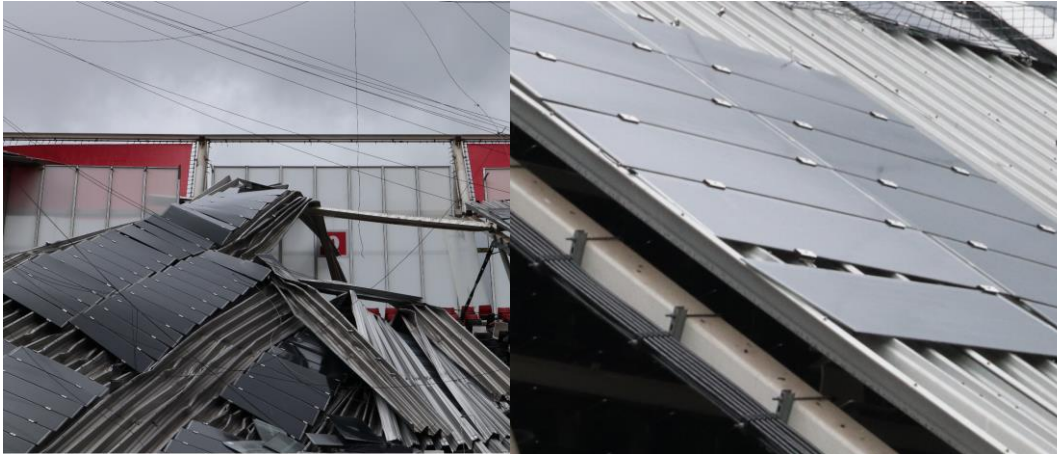
Figuur 7 Ingestort dak met zonnepanelen die zonder tussenruimte op de stalen dakplaten zijn gemonteerd [Bron: Onderzoeksraad - IMG_0275 en IMG_0280].
