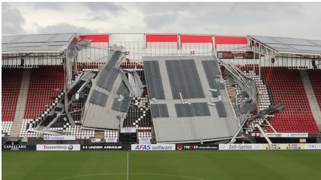
Figuur 1 Ingestorte dakconstructie AZ-stadion. [Bron: Onderzoeksraad - IMG_0356]
