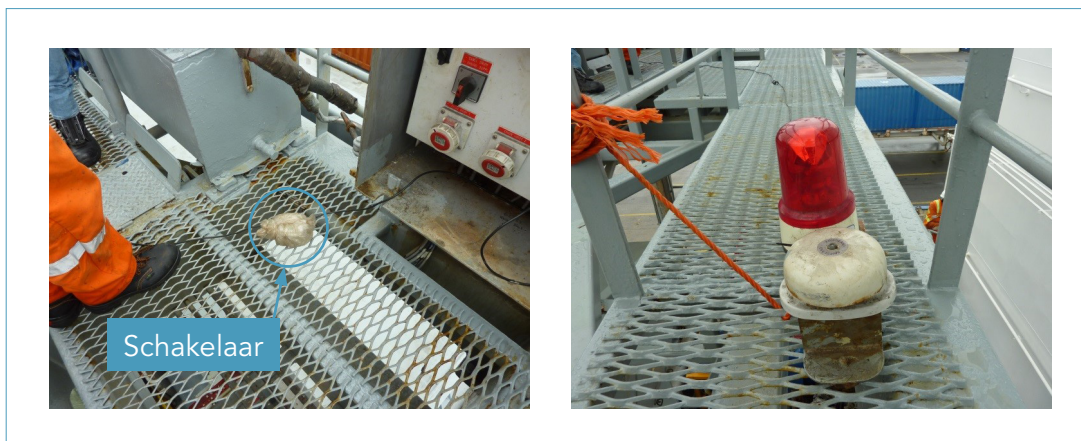
De alternatieve vorm van alarmering met links (figuur 8) de schakelaar en rechts (figuur 9) de alarmbel en het zwaailicht.
