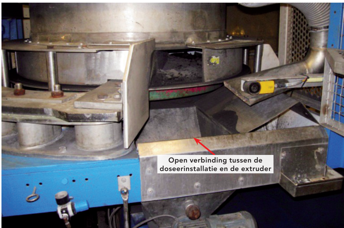
Figuur 1: De installatie. (Bron: BASF)
