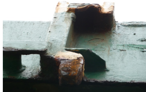
Foto 9: Beschadigd bevestigingspunt van het gevallen luik
