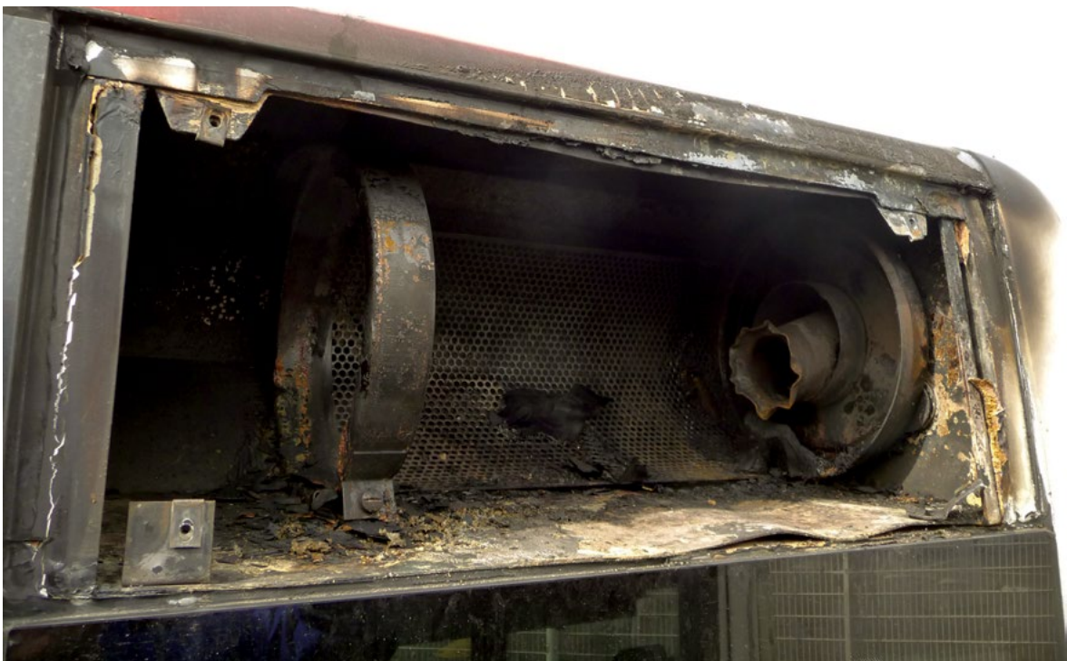
Figuur 2: De brandschade aan het luchtinlaatsysteem (na verwijdering van het afdekrooster).
