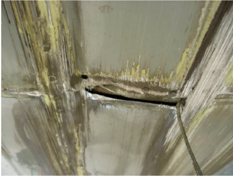
Afbeelding 3: close-up van het beschadigde gedeelte
