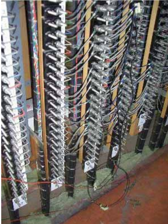
Afb. 7 Met zwarte lange snoeren zijn de stroppen (tijdelijke verbindingen) aangelegd in het relaishuis (Bron foto: Inspectie VenW).
