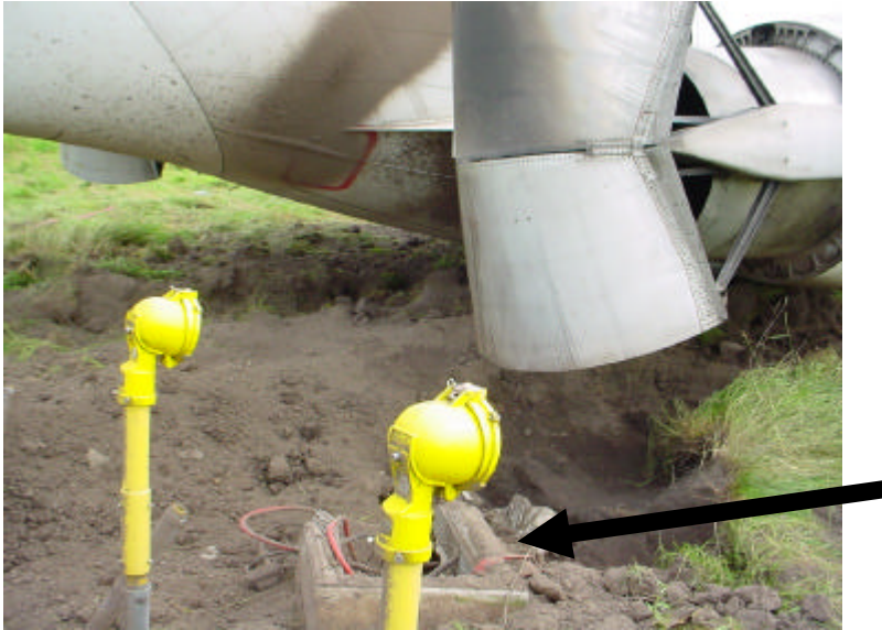
Figuur 4: betonnen transformatorput.
