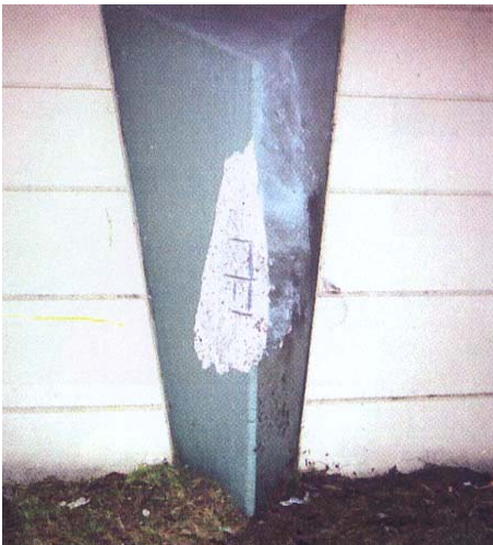
Figuur 4: De schade aan de steunkolom. Bron: Regiopolitie IJsselland.
