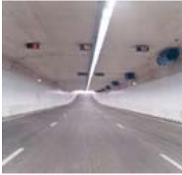
Afbeelding 12: Voorbeeld van matrixborden in een tunnel. Bron: Steunpunt Tunnelveiligheid.
