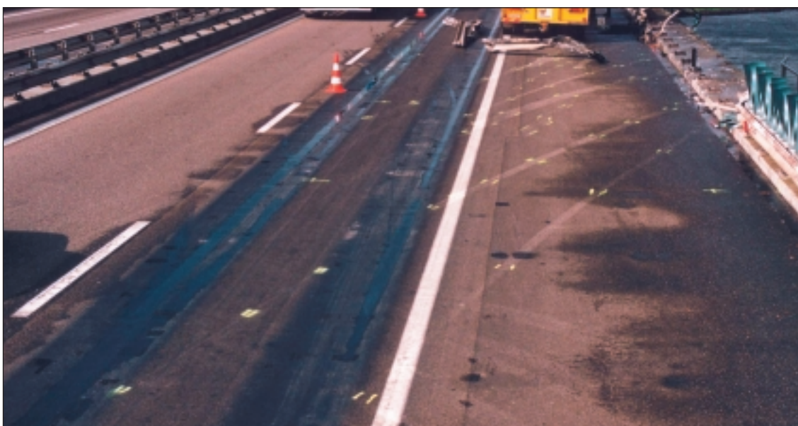
Figuur 4: Het vetgeslagen oppervlak, de spoorvorming en de gaten in het wegdek van de rechterrijstrook ter hoogte van de ongevalsplaats. Bron: politie Flevoland-Noord.
