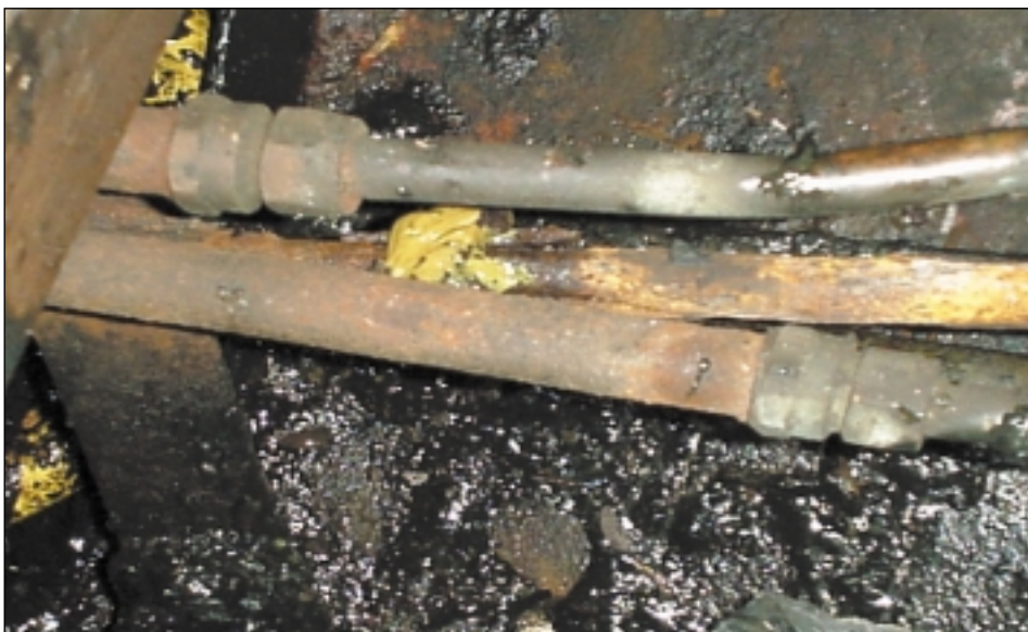
Figuur 3: Gescheurde persleiding van het smeersysteem
