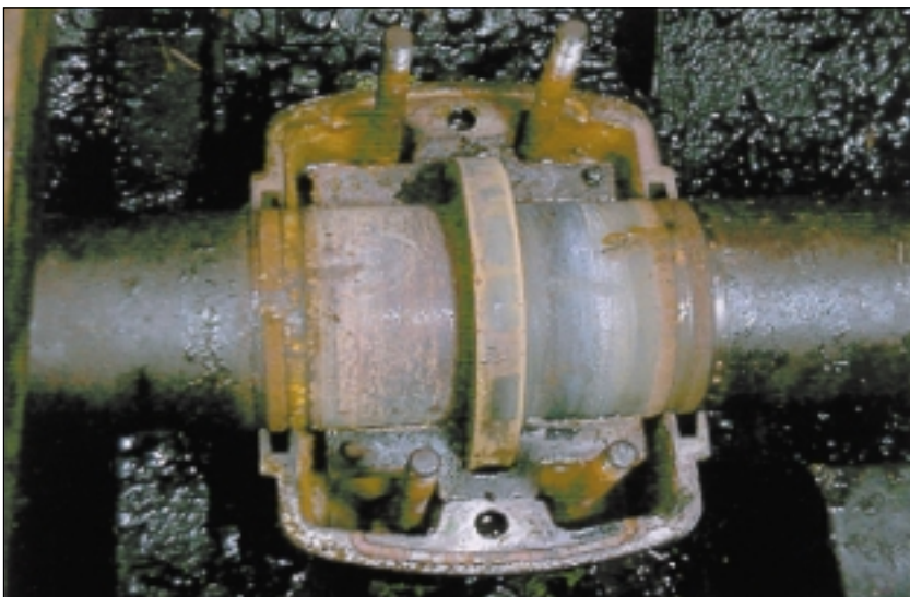
Figuur 6: Achterste steunlager van de schroefas
