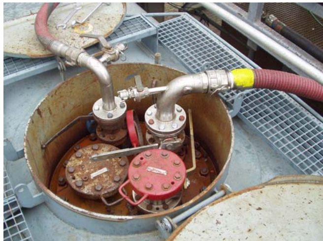
Afb. 9 De bovenkant van een reservoir met de kranen 4, 5, 6 en 7. Het reservoir komt voor wat betreft het type overeen met het reservoir in Amersfoort. De koppelleidingen zijn aangesloten.
