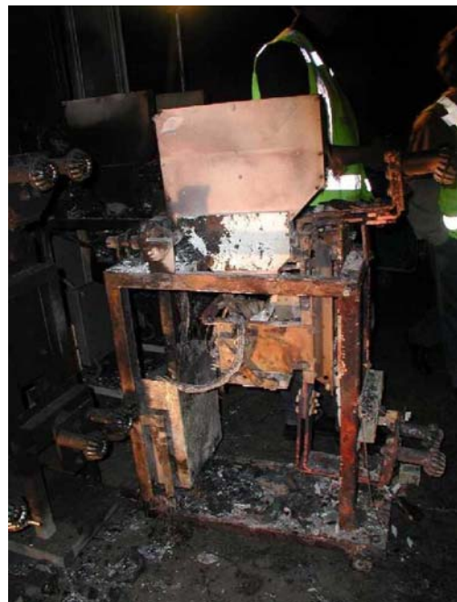
Afb. 9. De verbrande hoogspanning-schakelaar in station Schiphol
