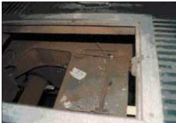
Afb. 9. Het geopende inspectieluikje in de vloer van de Metro. De vier ophangbouten van de motor, waarvan er twee zichtbaar zijn, kunnen makkelijk bereikt worden. Periodieke controle op het vastzitten van deze bouten met ring- of momentsleutel was voldoende geweest.
