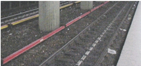
Afb. 3 Het ballastbed met de sporen. De rode constructie is de stroomvoorziening, die vóór het betreden van het ballastbed of het blussen met water eerst kortgesloten moet worden.
