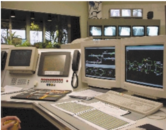
Afb. 2 Verkeersleiderspost. De twee computerschermen geven een schematisch overzicht van het net en de posities van de metro's en sneltrams daarop. Met behulp van het toetsenbord worden rijwegen ingesteld. Het systeem ernaast geeft de verbinding met de bestuurders op de lijnen 53, 54 en de openbare hulpdiensten. Het apparaat daarnaast geeft de verbinding met de bestuurders van lijn 51 (sneltram). Links buiten beeld bevindt zich de installatie voor de stationsomroep. Op de achtergrond zijn nog net de monitoren zichtbaar, die een beeld geven van de stations.
