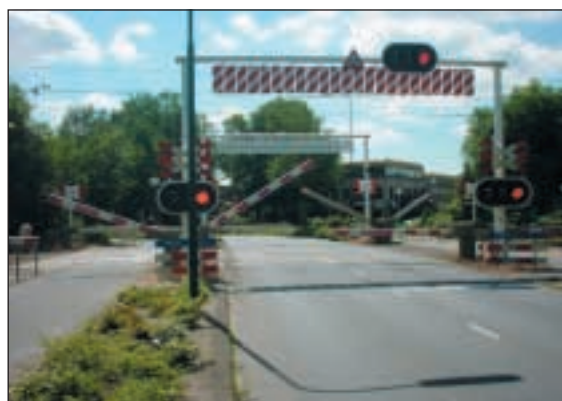
Figuur 18. De experimentele overweg in De Bilt. De bomen worden na elkaar gesloten. Een sensor – de witte ton links op de foto – controleert of de overweg na het sluiten van de bomen vrij is. Indien dit niet het geval is, dan moet de trein stoppen.
