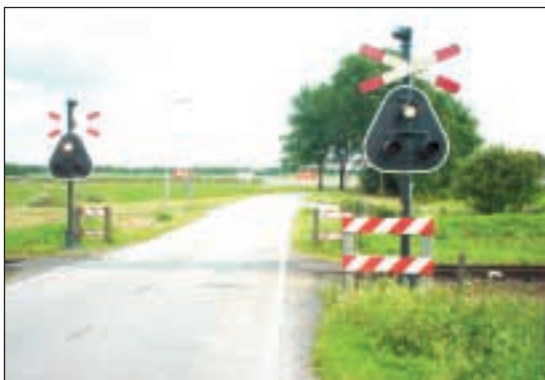
Figuur 13. Een overweg voorzien van een Automatische Knipperlichten Installatie (AKI). In 2001 waren nog 533 overwegen van AKI'S voorzien.
