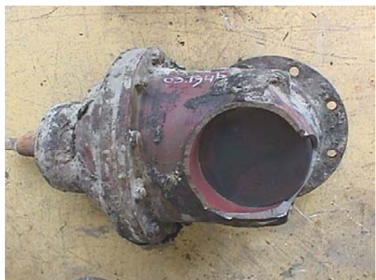
Figuur 4: De gescheurde gietijzeren afsluiter
